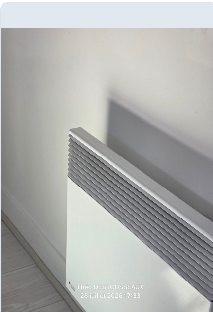
📷 Radiateur électrique mural des combles, vu depuis l'extérieur.
